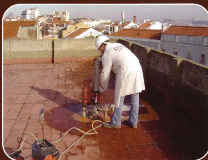
Extracção de carote na laje de cobertura de um edifício, para caracterização do material
